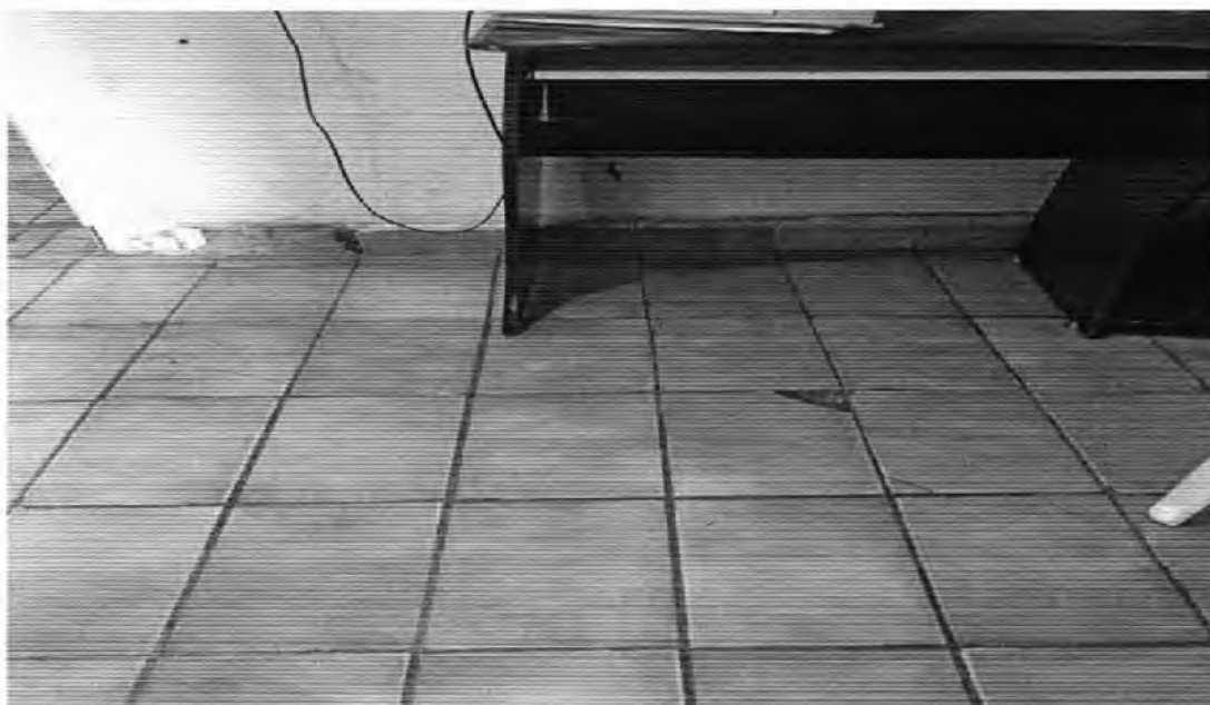
FOTO 6: Observou-se estufamento do revestimento cerâmico da sala
