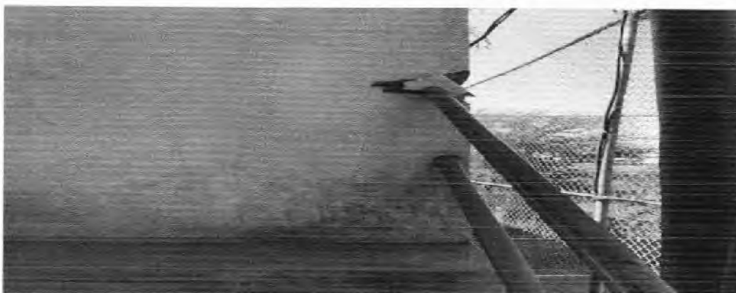
FOTO 6: Corrimão da escada necessitando de reparo.
