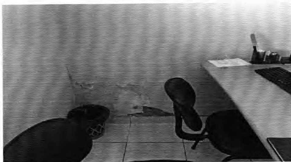
FOTO 5: Sala de trabalho 2, obs.: Infiltração nas paredes causada pela umidade do solo.
