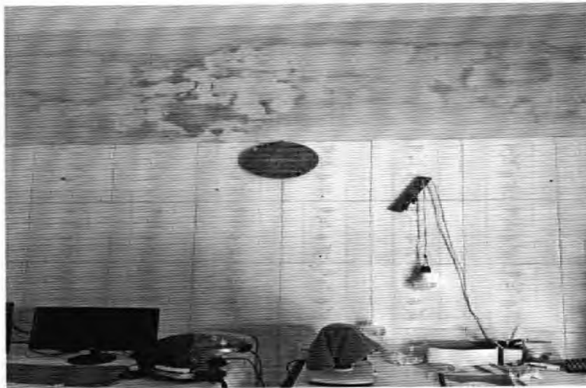
FOTO 5: Sala de trabalho 2, obs.: infiltração na parede.
