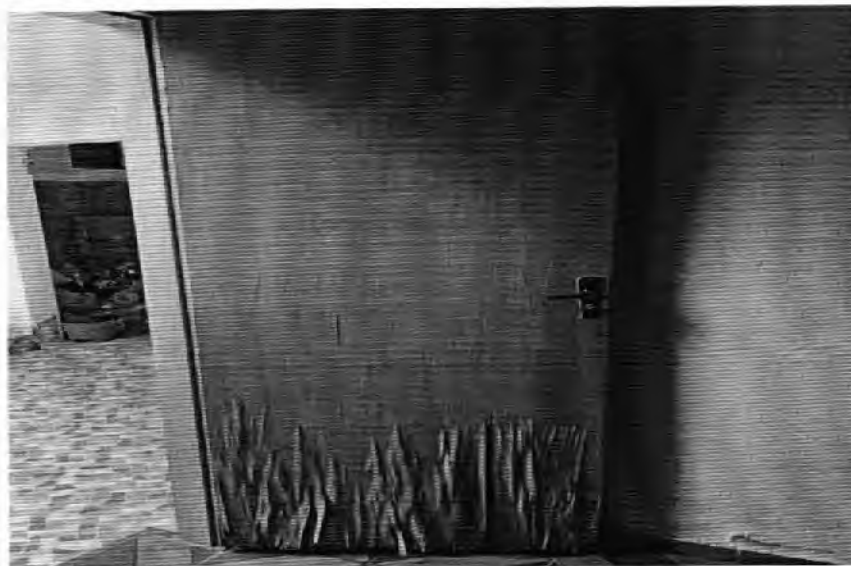
FOTO 6: porta de uma das salas danificada.
